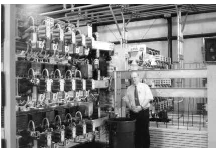
På besök i den allra första Statcom installationen i Sullivan substation, Tennessee 1997
