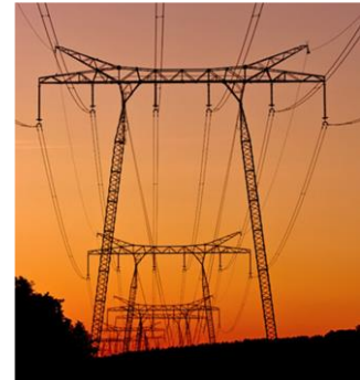
Dubbel 400 kV ledning i 800 kV stolpe © Puggen
