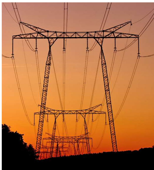
400 kV huvudkraftledningen mellan Forsmarks kärnkraftverk och Stockholm över Mälardalen i maj 2009. Foto: Puggen via Wikimedia Commons.
