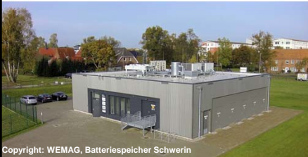
Copyright: WEMAG, Batteriespeicher Schwerin
