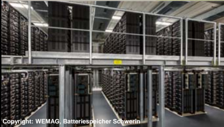
Copyright: WEMAG, Batteriespeicher Schwerin
